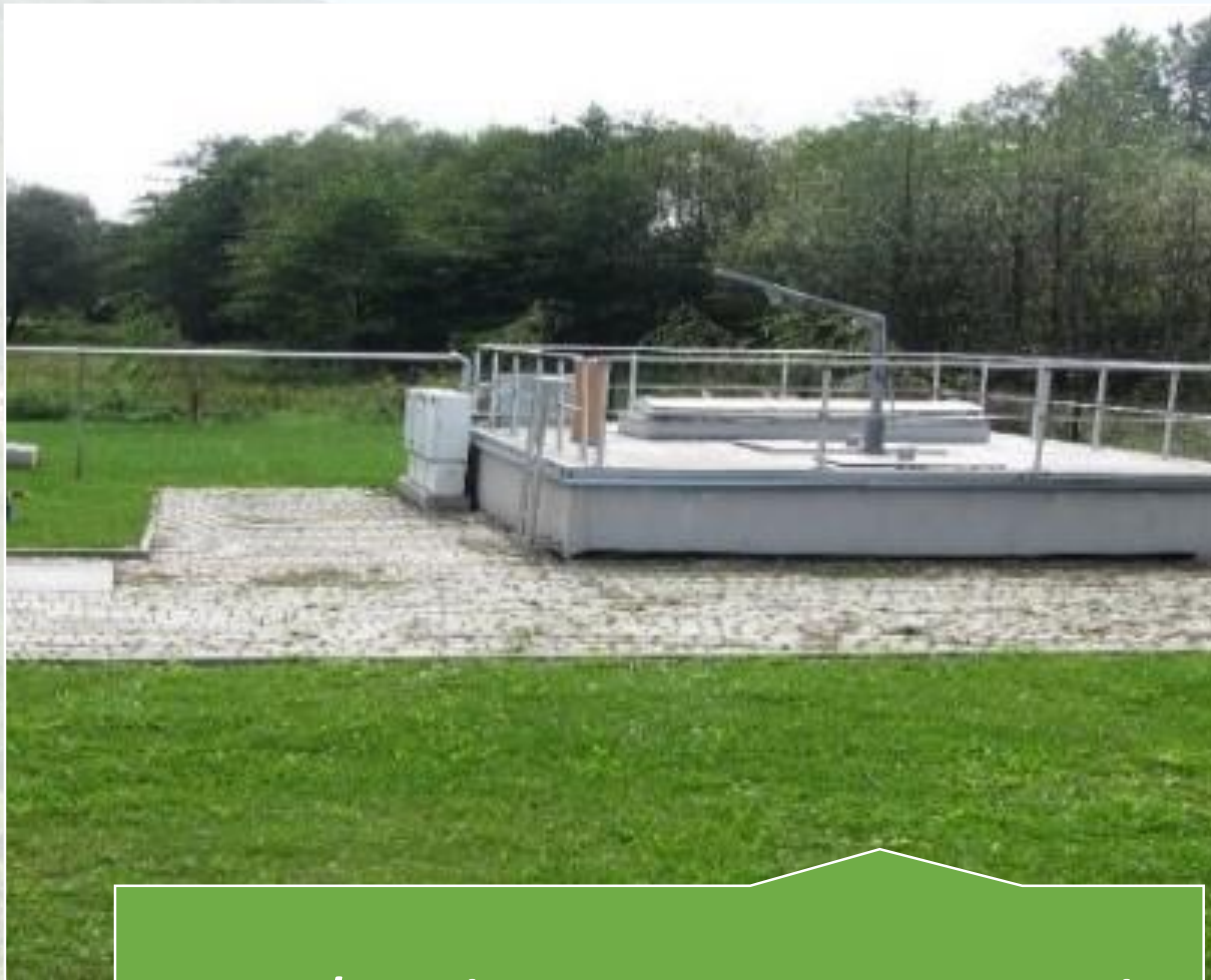
Zmodernizowana pompownia ścieków w Rybarzowicach
