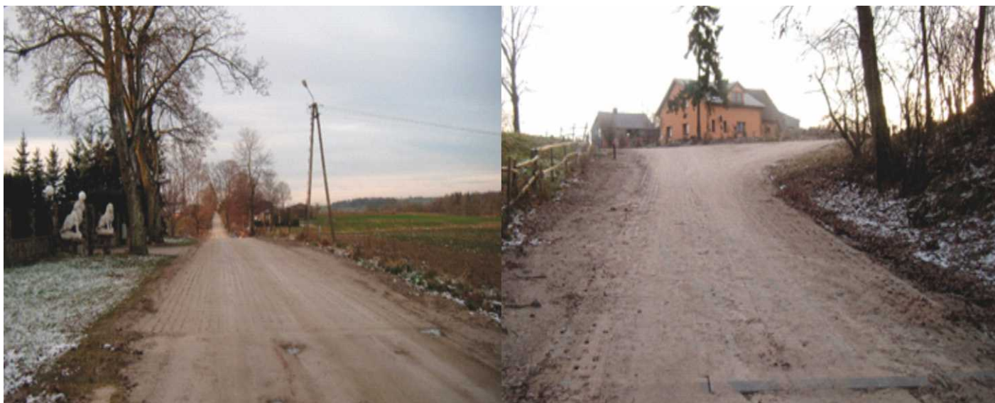
Kisewo – droga Kisewo - Łęczycze na odcinku ok. 800 mb - utwardzenie drogi płytami IOMB
