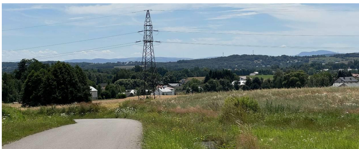
Ryc. 12 Napowietrzna linia wysokiego napięcia (źródło: fotografia własna)
