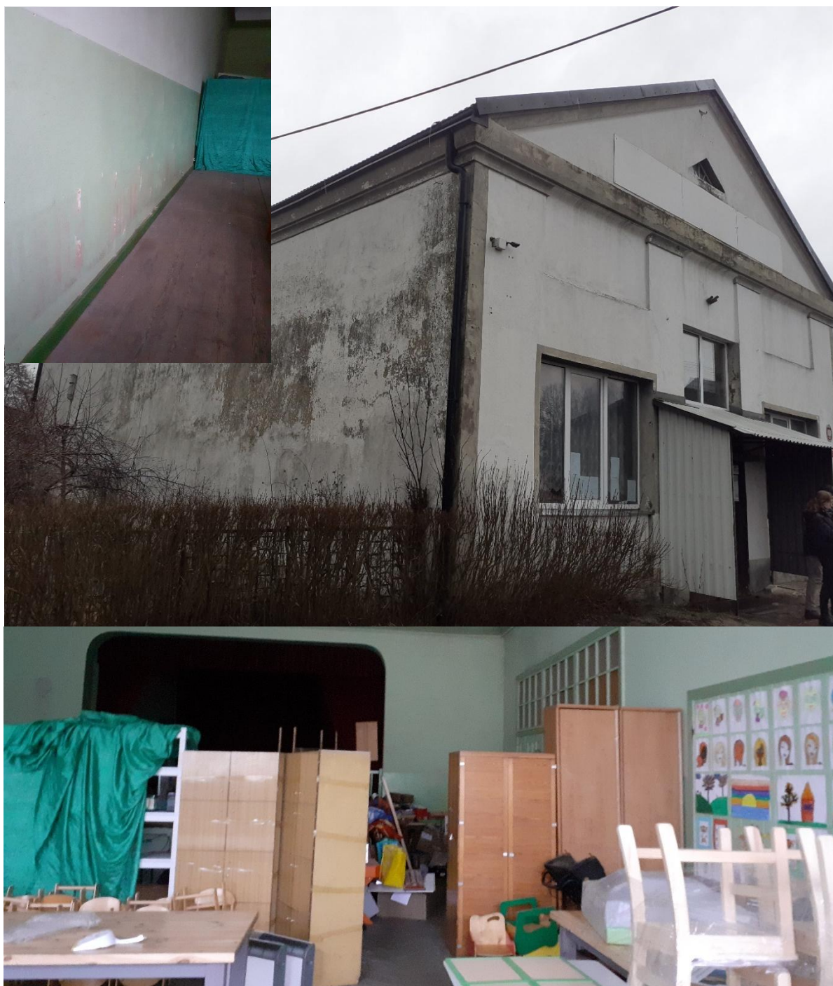
Rycina 26. Stan techniczny Sali Wiejskiej w Hucie Szklanej
