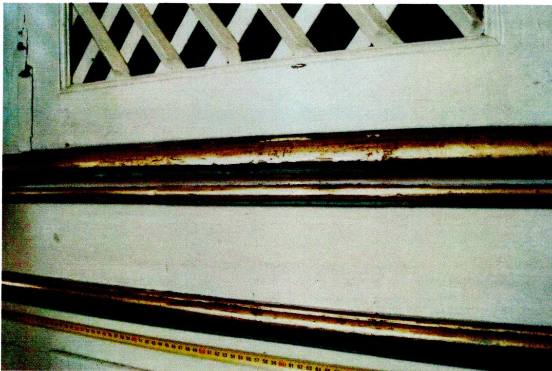
W kadrze widoczne uszkodzenia struktury drewna (po lewej stronie kadru) oraz przetarcia i oksydacja szlagmetal. Gruba powłoka farby którą pokryta jest większość struktury prospektu miejscami odpryskuje.
