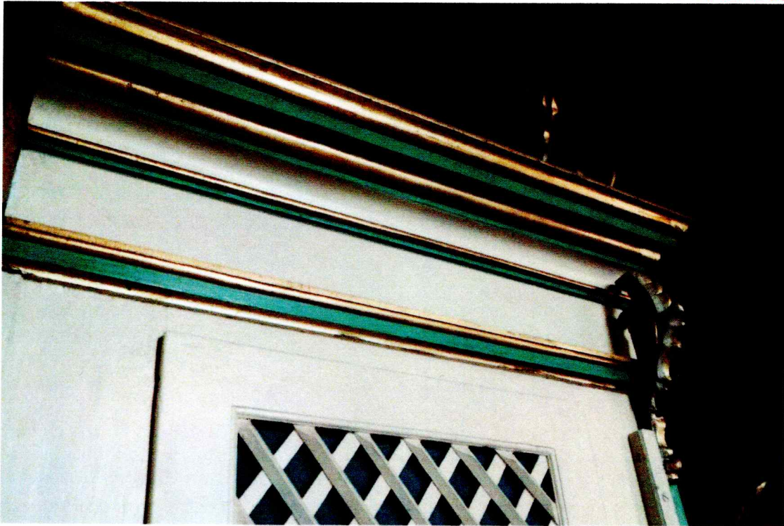
Gzyms koronujący prawy ryzalit szafy organowej. Widoczne przetarcia i występujące lokalnie obszary oksydacji na dekorowanych szlagmetalem profilach.
