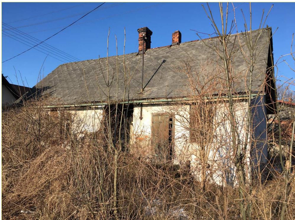
Rysunek 25 Zaniedbany budynek pokryty powłokami azbestowymi przy ulicy Wyzwolenia w Buczkowicach
