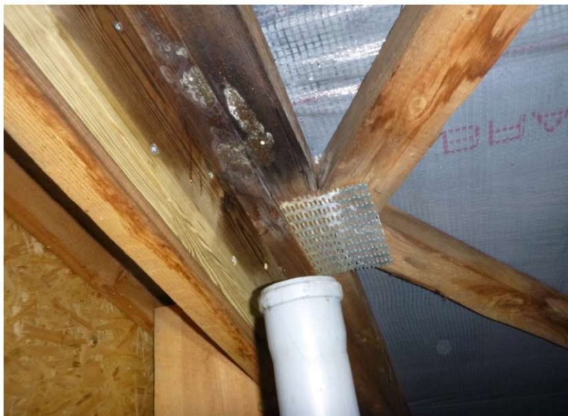
Fot. 7.1 Wskutek kolizji wywiewki kanalizacji z elementem konstrukcji, zakończono rurę pod elementem drewnianym, czego efektem jest widoczna na zdjęciu korozja biologiczna elementu drewnianego (fot. U. Kotwica)
