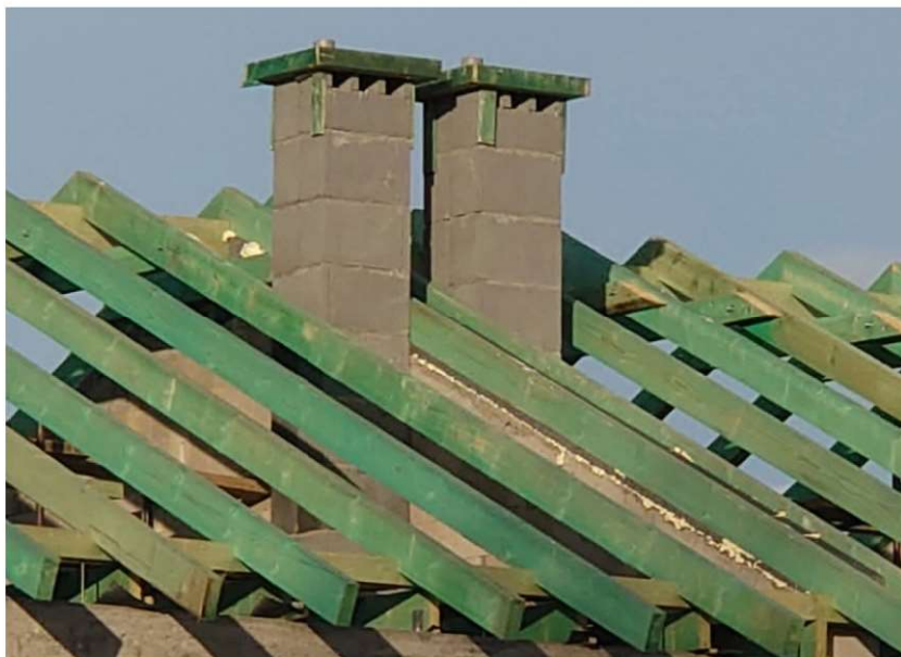
Fot. 2.2 Mniej lub bardziej intensywne zielone zabarwienie konstrukcji nie świadczy o poprawnej impregnacji (fot. E.I. Kotwica)
