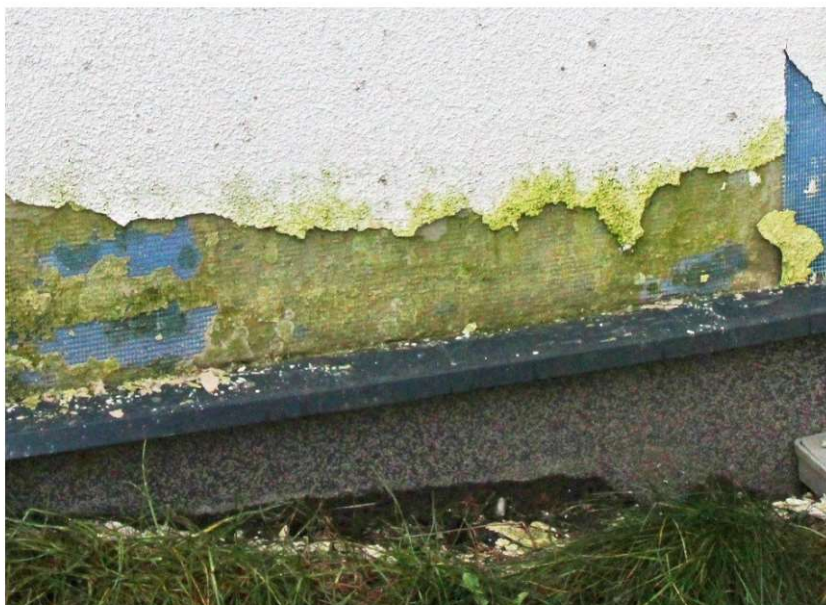
Fot. 3.1 Niepoprawnie zaprojektowany i wykonany detal połączenia ściany budynku ze ścianą fundamentową – wykonanie cokół wystającego poza lico ściany skutkuje zaleganiem wody i korozją w obrębie ściany, cokół jest też za niski (fot. E.I. Kotwica)
